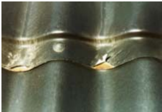
Fotografia arată coroziunea de la muchiile tablei la baza părții ondulate. Exemplu de neglijare a întreinerii
